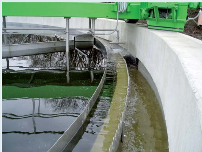
Dosazovací nádrž na ČOV Lipník n.B.
