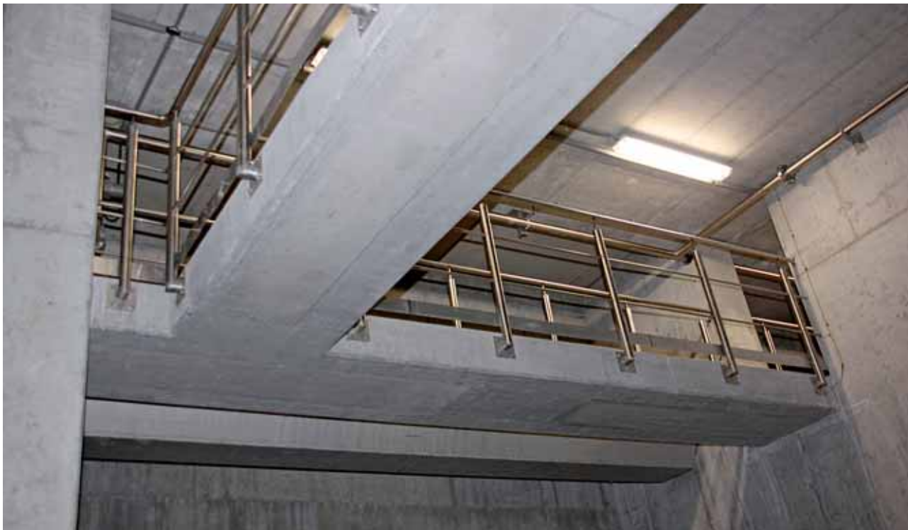
Obslužná lávka v retenční nádrži RN - OK 1A
