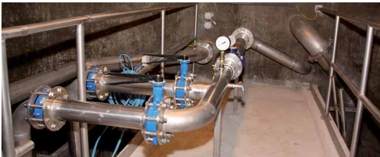
Technologické vybavení ČS Ústí
