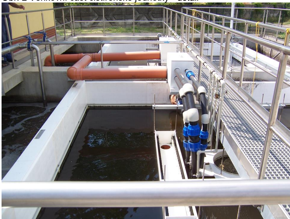
Obr. 2 Venkovní část čistírenské jednotky - detail
